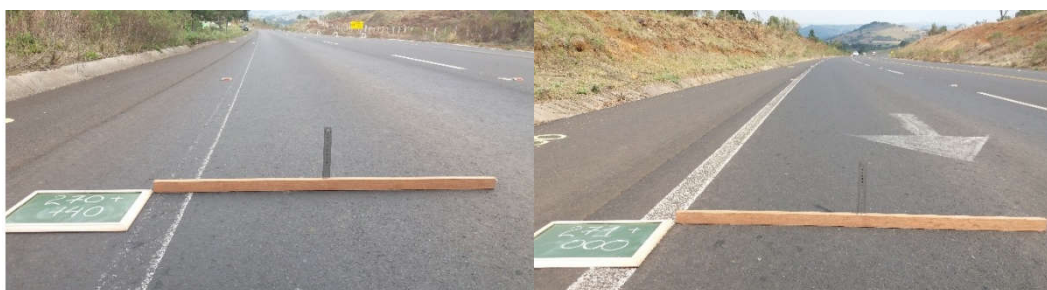
Figura 5. Levantamento em 2019 do afundamento de trilha de roda.
