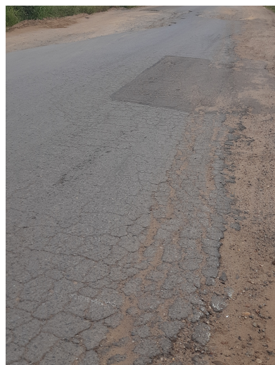
(b) couro de jacaré com erosão
