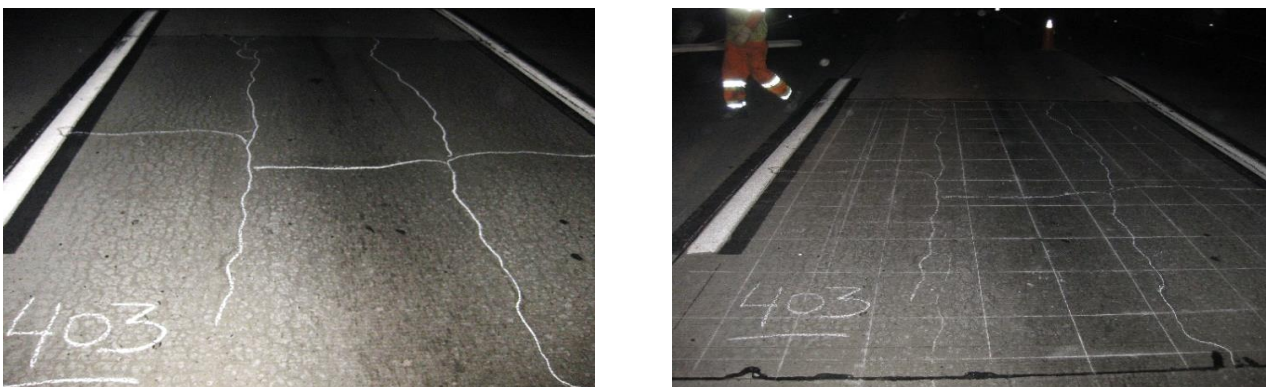
Figura 6. Identificação das fissuras e demarcação das ranhuras (AUTORES, 2019)
