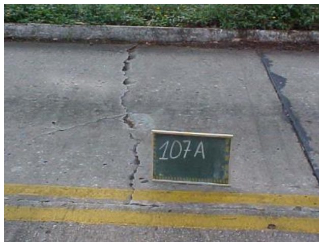
Figura 1: Fissura transversal em pavimento rígido. (AUTOR: DNIT 061/2004-TER)
