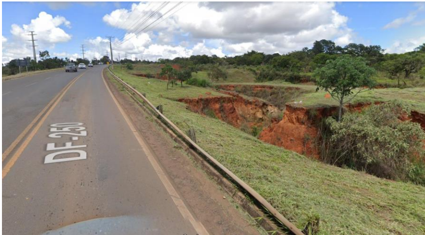
Figura 1 - Processo erosivos às margens da Rodovia DF-250 (GOOGLE MAPS, 2023)
