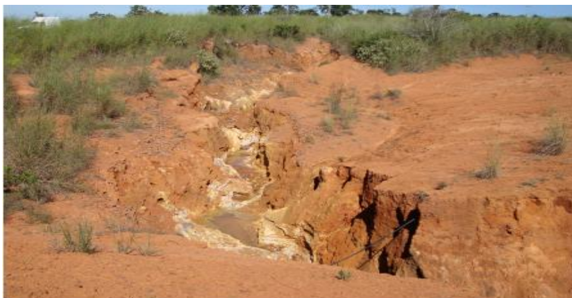
Figura 2 – Trecho da voçoroca em direção ao Córrego Capão da Erva (AS CONSULT, 2018)
