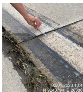
Figura 11. Escalonamento ou degrau nas juntas (AUTORES 2023).
