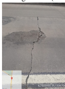
Figura 7. Fissura transversal (AUTORES 2023).
