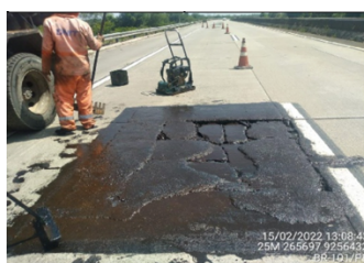
Figura 5. Quebra localizada (DNIT/PB 2022).
