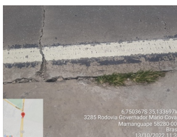
Figura 8. Dano na selagem de junta (AUTORES 2023).
