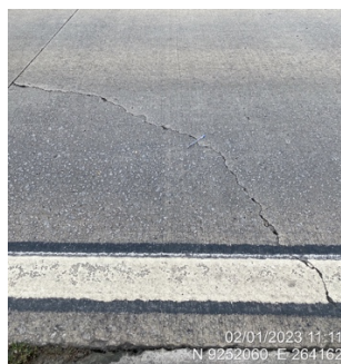
Figura 4. Fissura de canto (AUTORES 2023).
