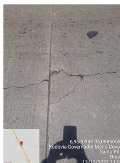
Figura 10. Esborcinamento de junta (AUTORES 2023).
