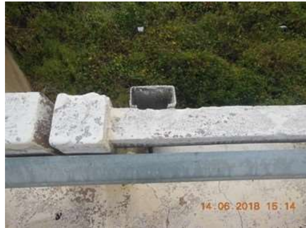
Figura 15. Vista superior com detalhe da fixação da lâmina ao guarda-corpo. (Fonte: próprio autor, 2019).
