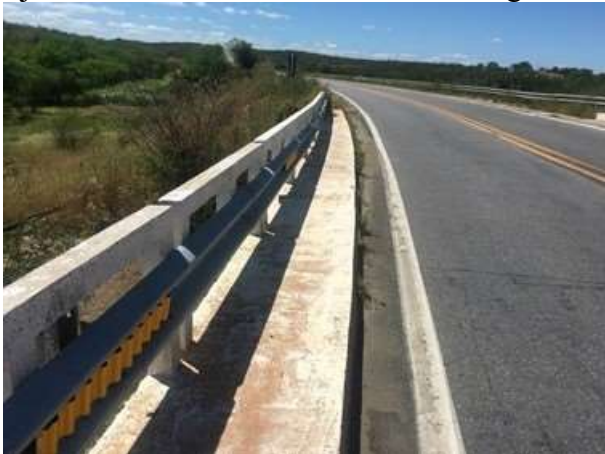
Figura 11. Defesa metálica fixada junto ao guarda-corpo da Ponte sobre o Rio Sussuarana. (Fonte: próprio autor, 2019)
