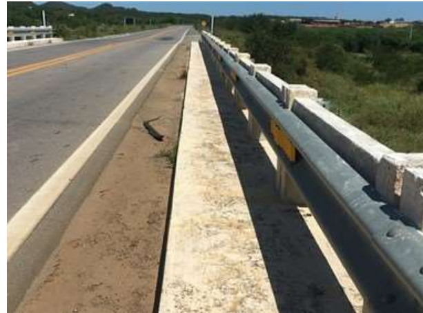
Figura 12. Defesa metálica fixada junto ao guarda-corpo da Ponte sobre o rio Maniçoba. (Fonte: próprio autor, 2019).
