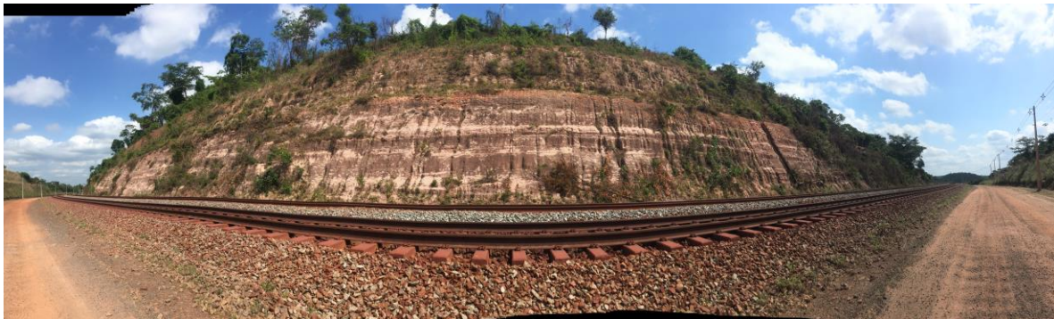
Figura 2 – Vista Frontal do Corte com Percolação de Água da Face do Talude, Apresentando Formação de Erosões Superficiais e Evoluindo a Ravinas (AUTOR, 2022).
