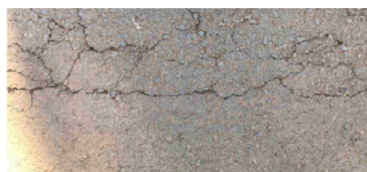
Figura 5. Baja severidad "Fatigue cracking"
