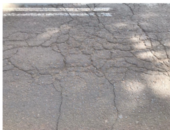
Figura 7. Severidad alta "Fatigue cracking"
