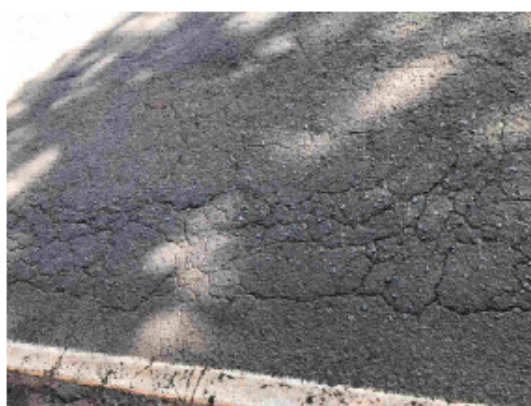
Figura 6. Severidad intermedia "Fatigue cracking"
